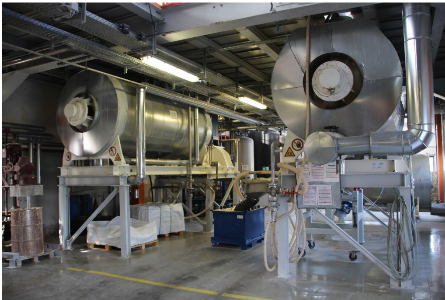
Bereich Trocknungsservice: Produktionshalle mit Schaufeltrockner
